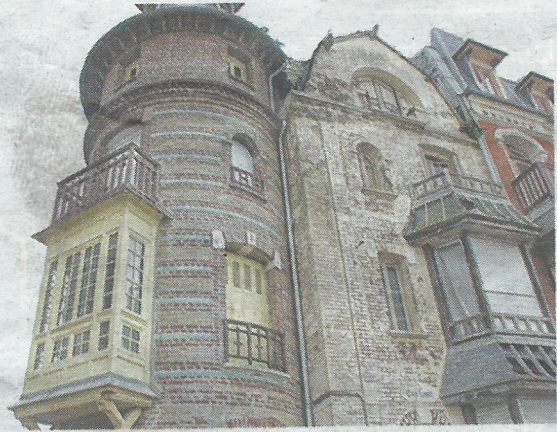
La ville de Mers-les-Bains va devoir financer des travaux d'urgence sur une villa délabrée de l'esplanade.
